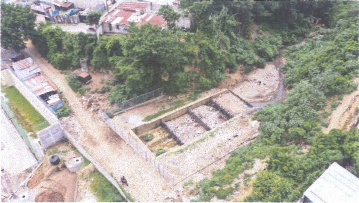
Vista aérea del sedimentador.
