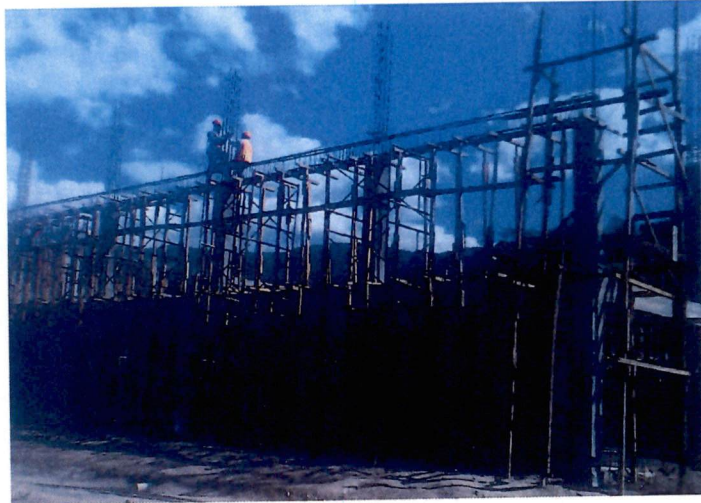
Preparación de vigas en el edificio de Taller de Tecnología del Automóvil
